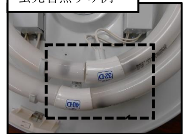
蛍光灯黒ずみ例
